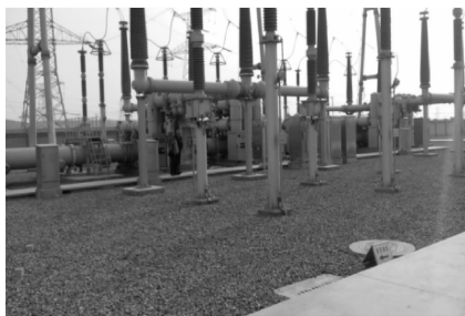
图 6 凯歌 330 kV 变电站
